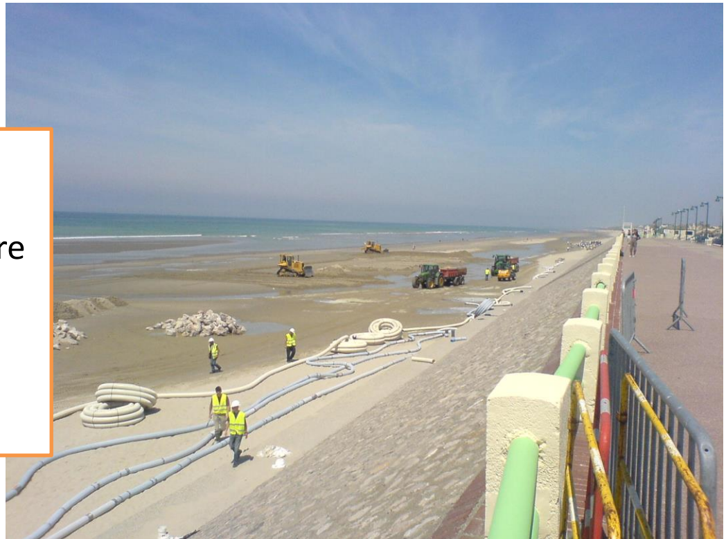
Système de Pompage à Quend (80)
